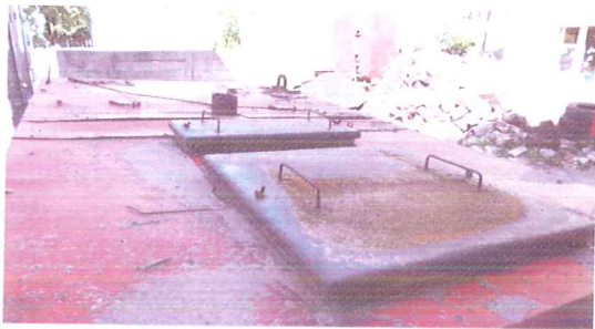
Górna część pieca z pokrywami wyczystnymi Czopuch
